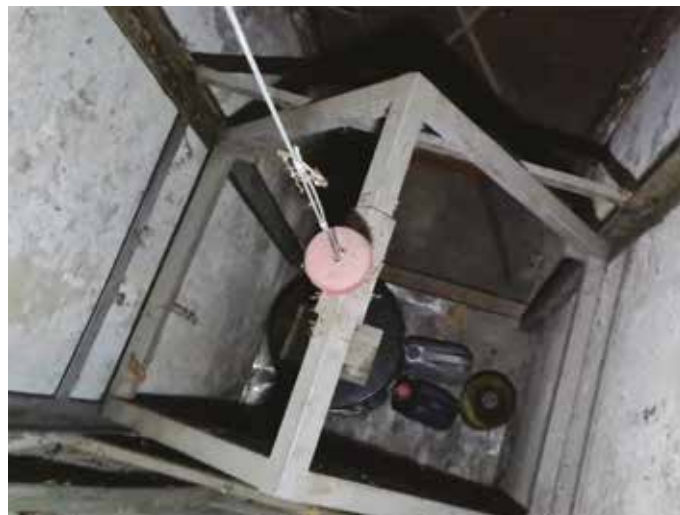
Celoročně vytápěný komplex vyjetým olejem v necertifikovaném zařízení a výtah, který podle KN neexistuje, na dopravování sudů do podzemí.
