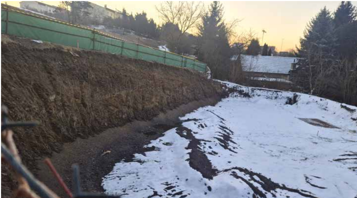
„Základy drobné stavby“ vypadají spíše na přestupní stanici metra
